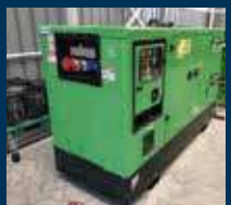
Generador Eléctrico 110KVA
